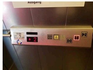
Bedienelemente im Fahrstuhl
